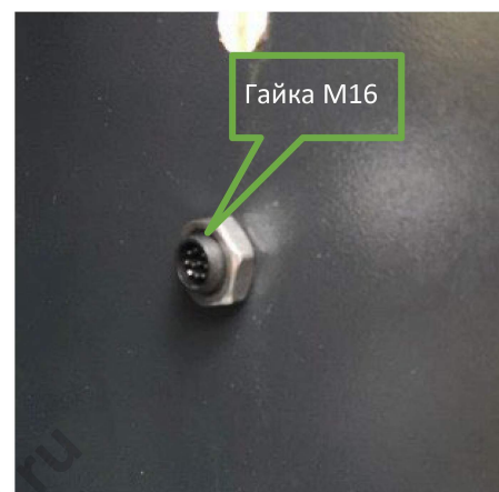
(b) Прокладка проводки через прокладку и гайку
